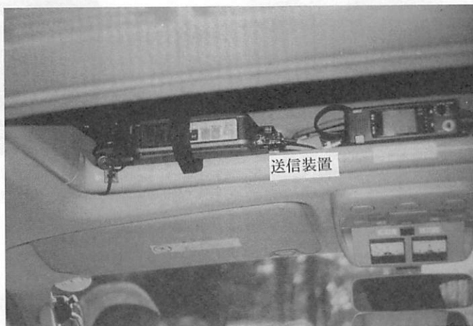
写真2 救急車内の天井棚に設置された送信装置
