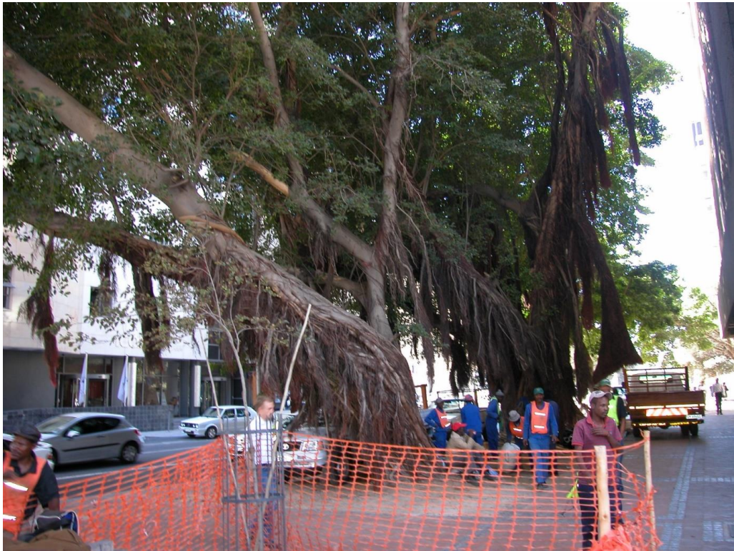
(写真 南アフリカの木陰での作業) 南アフリカ・ケープタウン；2010 ワールドサッカーに向けての道路工事 2009. 3. 日中30℃、夕方20℃弱、
